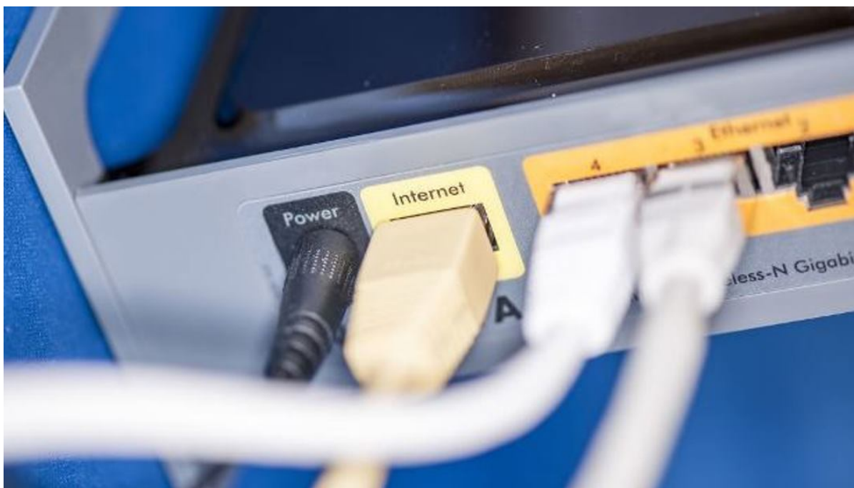
Netværkskabel tilsluttet pc. Foto: Frederikssund kommune, Kenneth Jensen.
