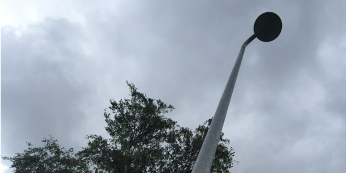
Gadelampe. Foto: Frederikssund Kommune.
