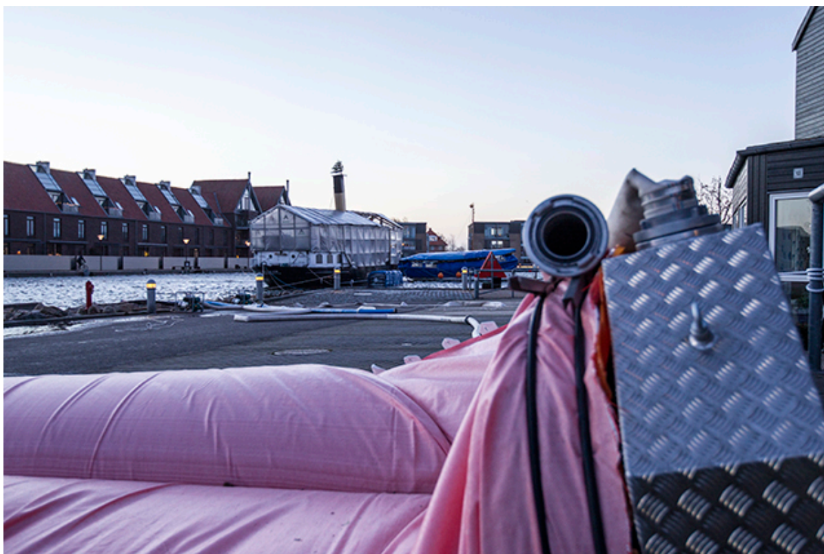
Udlægning af watertubes på Nordkajen i Frederikssund. Foto: Kenneth Jensen, Frederikssund Kommune.
