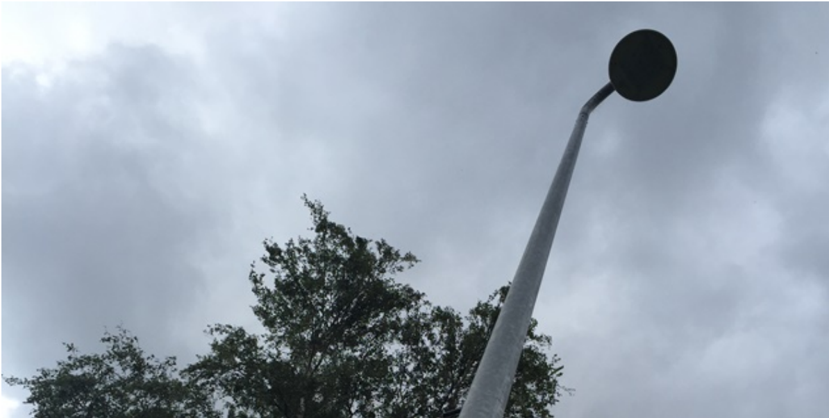
Slukket gadelampe. Foto: Frederikssund Kommune.
