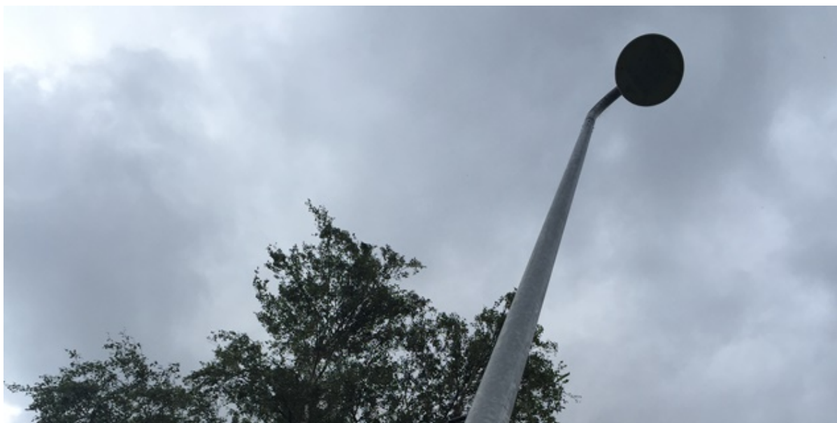
Slukket gadelampe. Foto: Frederikssund Kommune.
