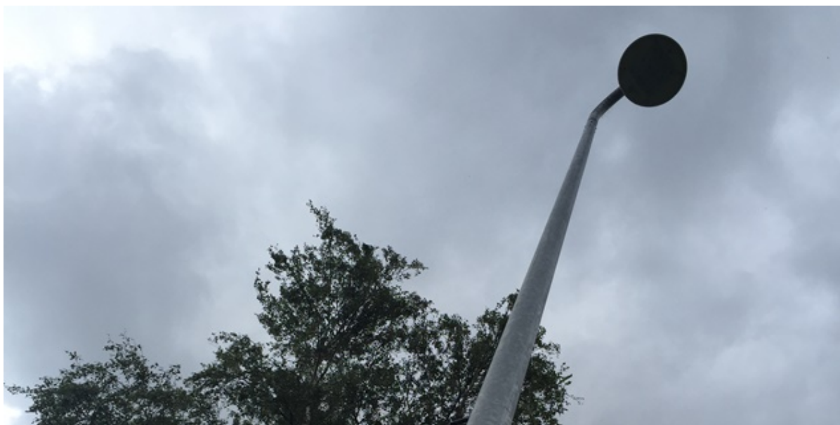
Slukket gadelampe. Foto: Frederikssund Kommune.
