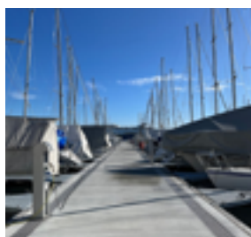
El-installation i bådebro
