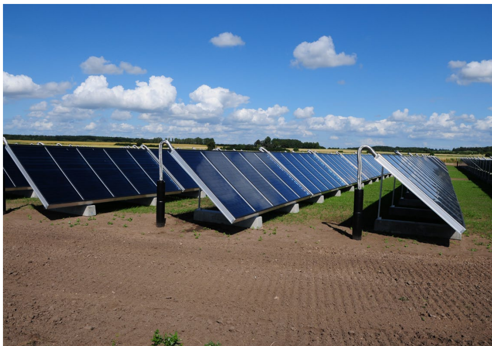
Solvarmeanlæg leverer om sommeren en stor del af fjernvarmen i Skuldelev og Jægerspris.
