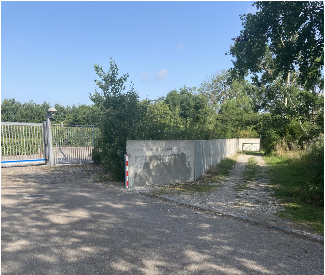
Figur 2.9: Foto 8: Grusvej rundt om renseanlægget samt betonmur ind mod renseanlægget. Set mod nordvest. NIRAS, 16-07-2021.
