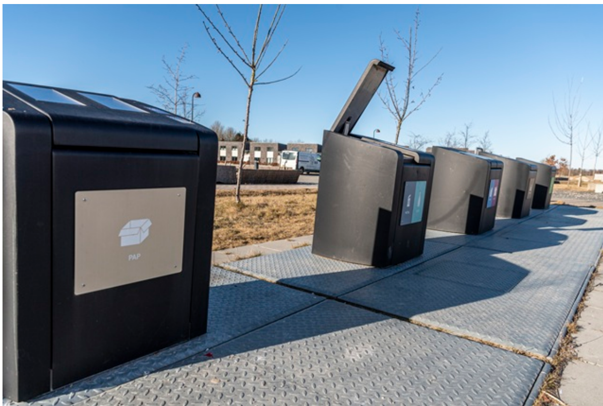
Nedgravede affaldscontainere i Vinge. Foto: Kenneth Jensen.
