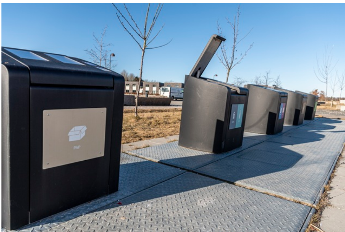
Nedgravede affaldscontainere i Vinge. Foto: Kenneth Jensen.
