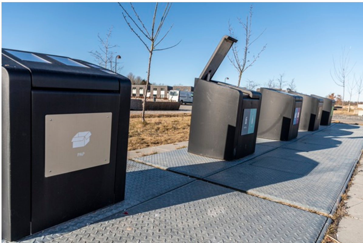
Nedgravede affaldscontainere i Vinge. Foto: Kenneth Jensen.
