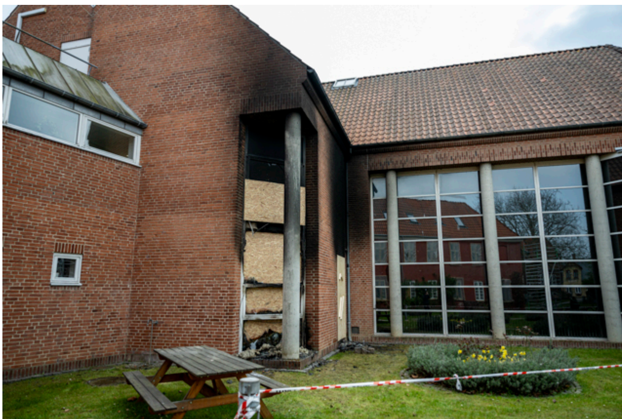
Brandskader på husets bagside. Foto: Kenneth Jensen.
