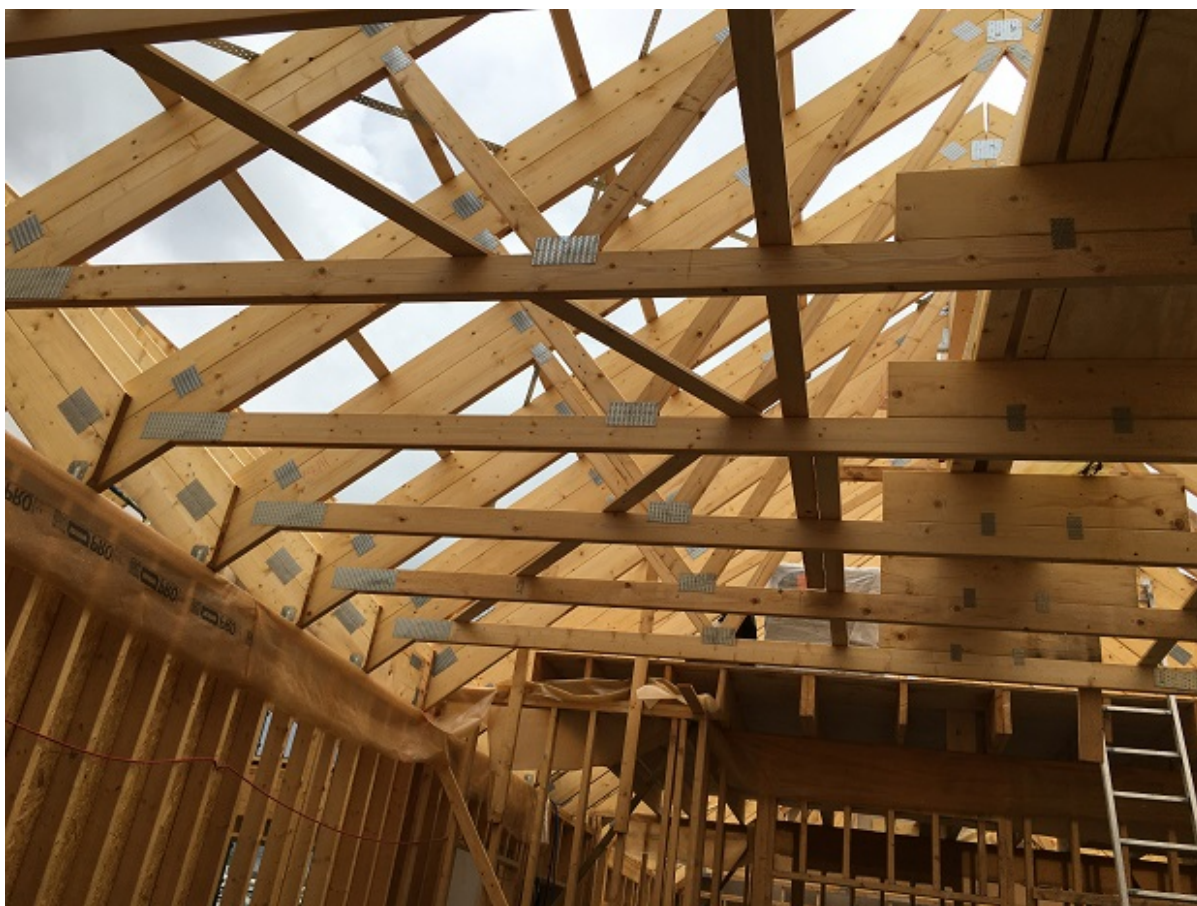
Tagspær på Børnehuset Gyldensten. Foto: Frederikssund Kommune.
