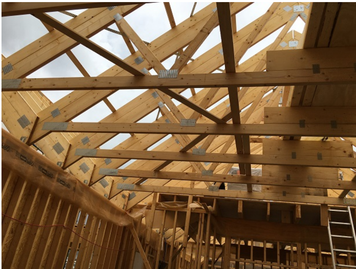
Tagspær på Børnehuset Gyldensten. Foto: Frederikssund Kommune.
