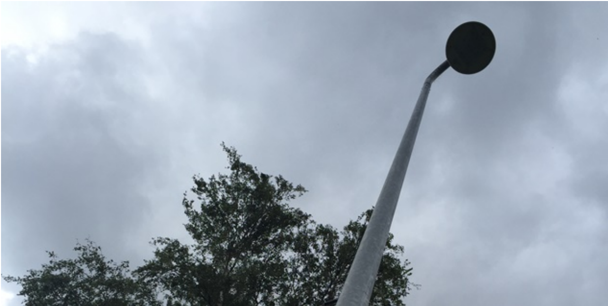
Slukket gadelampe. Foto: Frederikssund Kommune.
