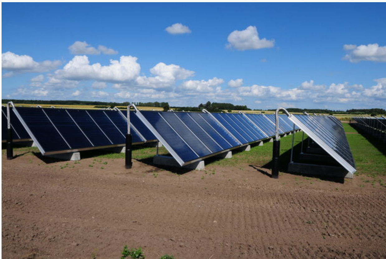
Solvarmeanlæg ved Jægerspris.
