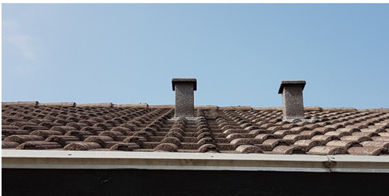
Faldstammeudluftning på et hustag. Foto: Frederikssund Kommune.
