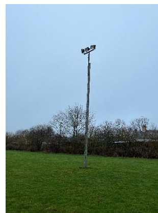
Lysmast med 3 armaturer
