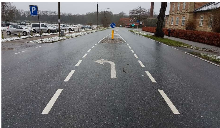
Smal og kort venstresvingsbane (som i øvrigt ikke er afmærket korrekt).
