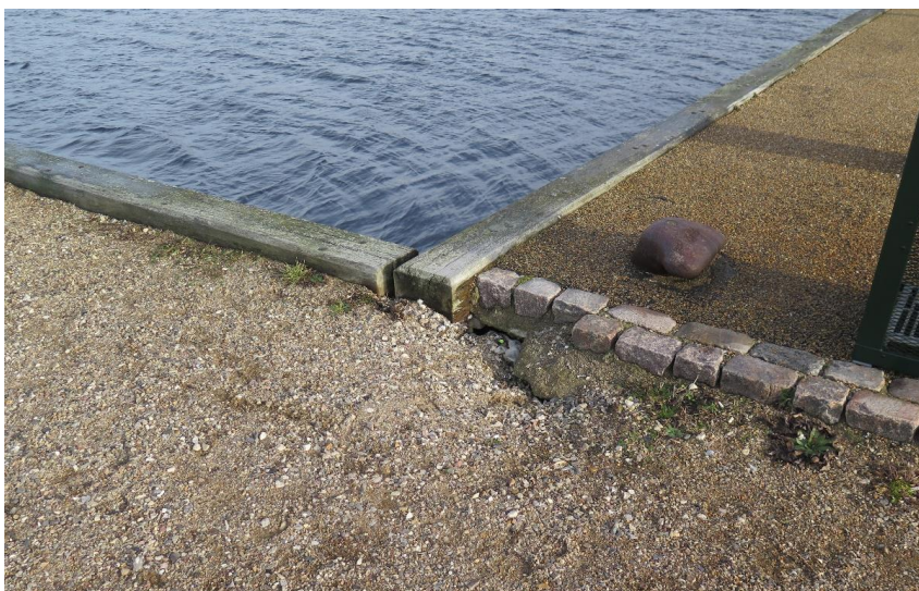
Figur 15: Sætning ved hjørne af Operakajen og Sydkajen.
