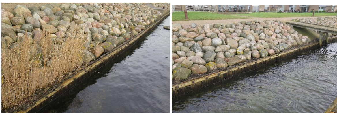
Figur 21: Spuns foran stensætning i meget dårlig stand.
