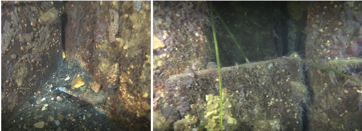
Figur 17: Åbning i stålspons ved bund. Operakaj – Sydkajen, bund til venstre top til højre.
