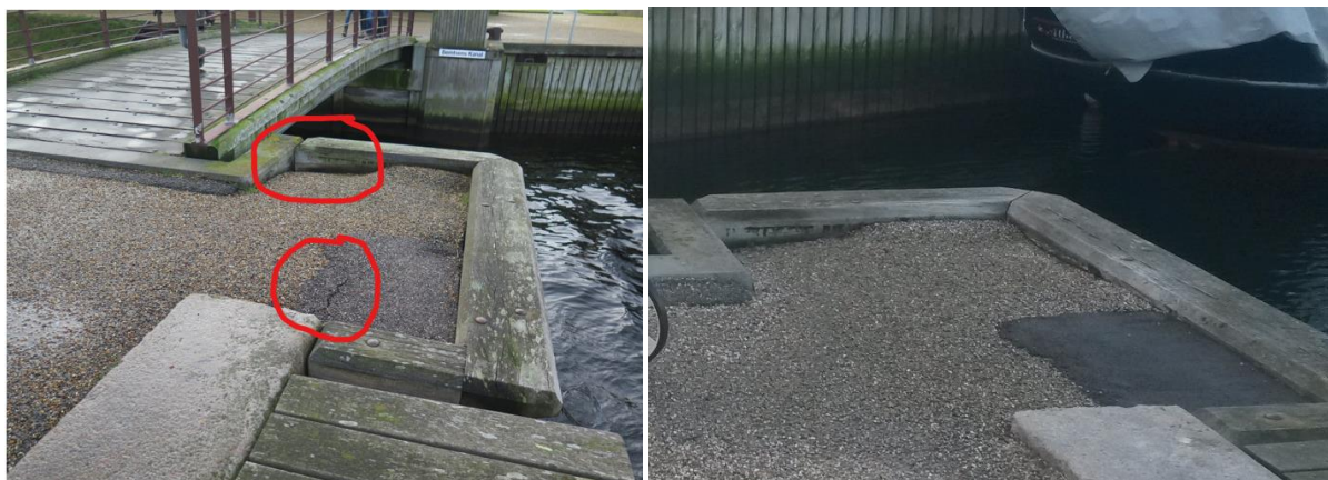
Figur 18: Sætninger i belægning ved kanal. 2023 til venstre og 2016 til højre.
