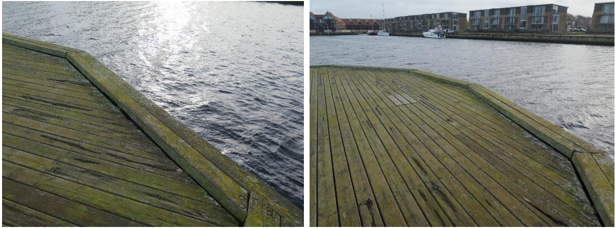
Figur 4: Gang areal af molehoved. Der er begyndende råd i gangbrædder.
