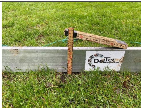
Figur 120: Ujævnheder generelt under 2 cm under 3 meter retskede. Jeg kunne oplede enkelte ujævnheder på op til 2,5 cm.
