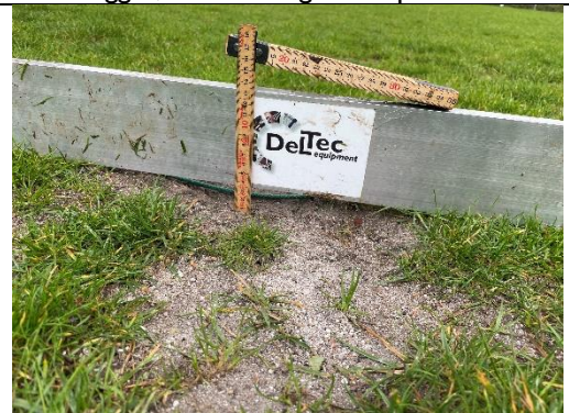
Figur 139: Gennemslidning på 3,5 cm under 3 meter retskede.
