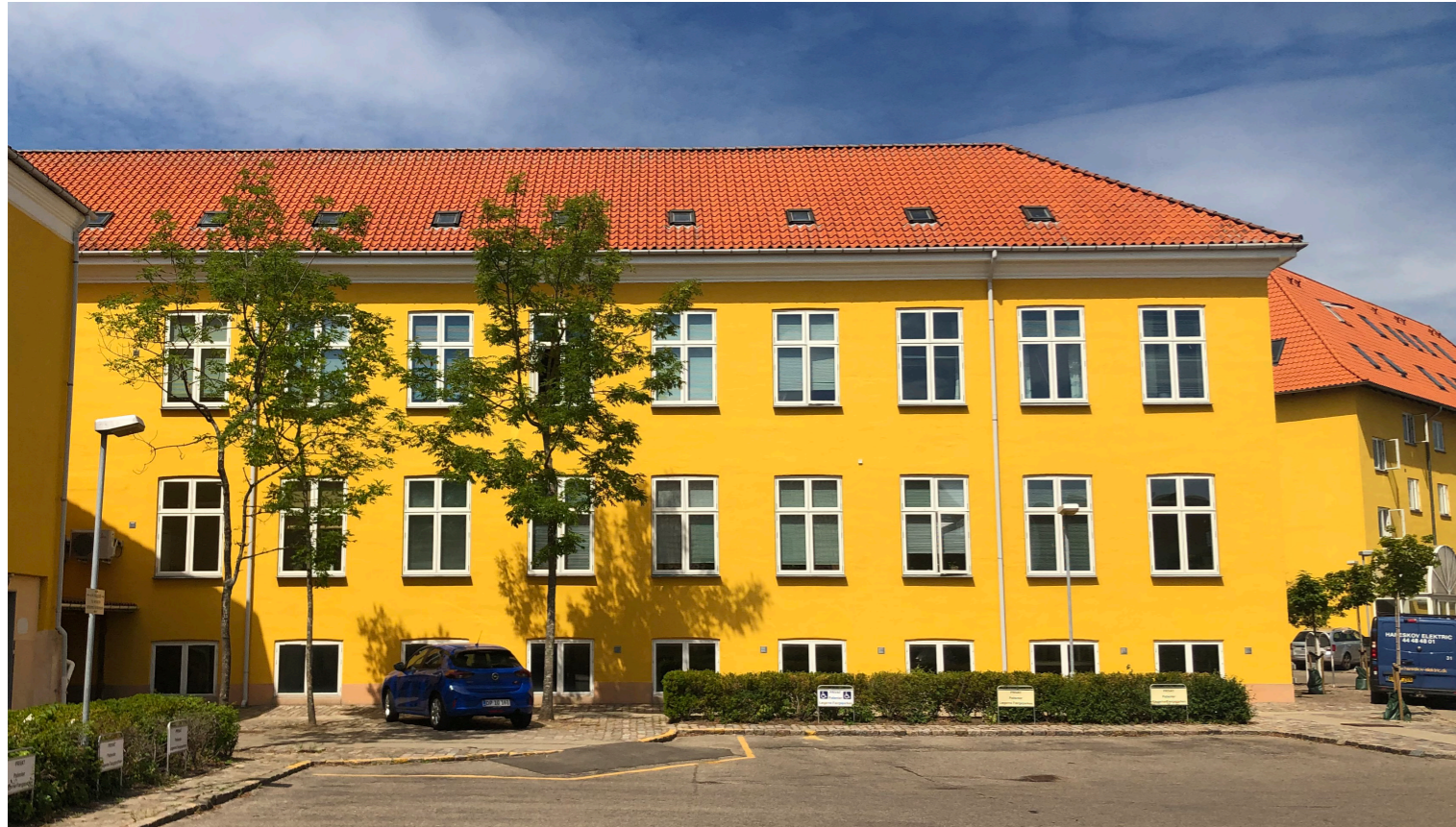
Eksisterende forhold - manglende kviste i tagfladen ifht oprindeligt
