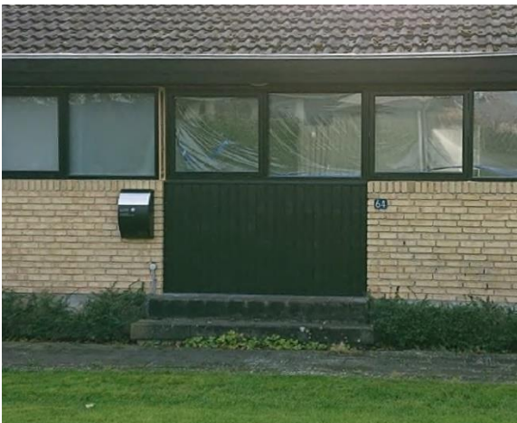
Ulovlig blænding af indgangsparti, da det er halvt beklædt med træ og halvt i glas.
