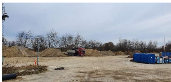
Eksempel på ressourceplads hos NK Forsyning
